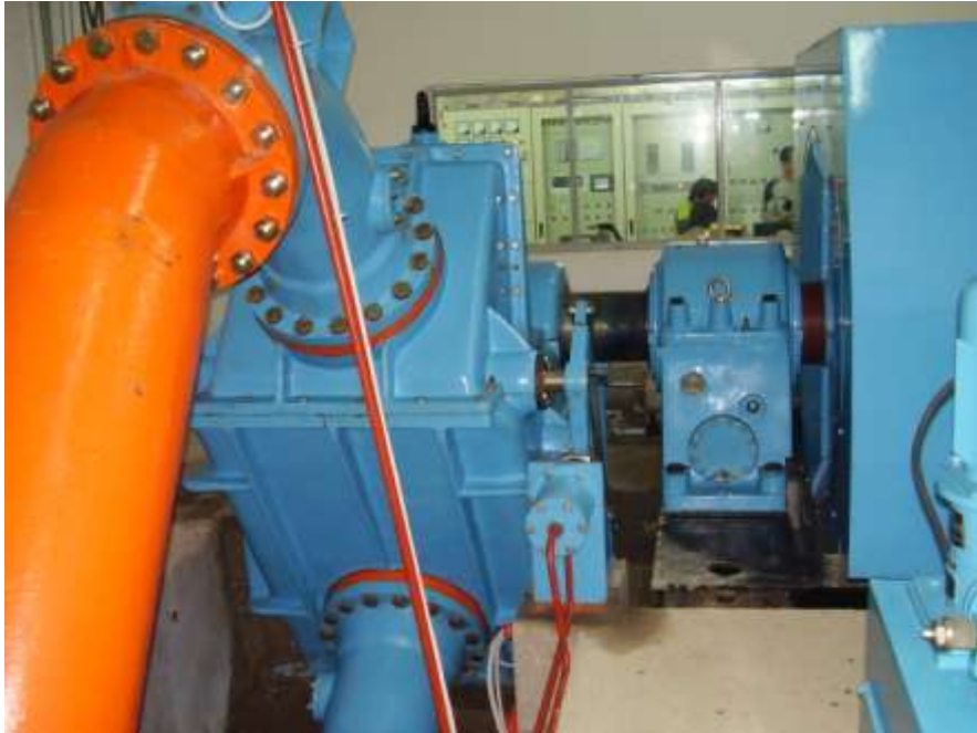
TURBINA I GENERATOR
